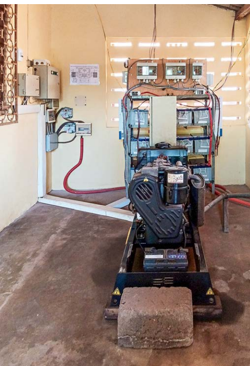
Alte und neue Technik in Reih und Glied: Im Vordergrund steht der Dieselmotor, hinten die neu installierten Batteriespeicher.
