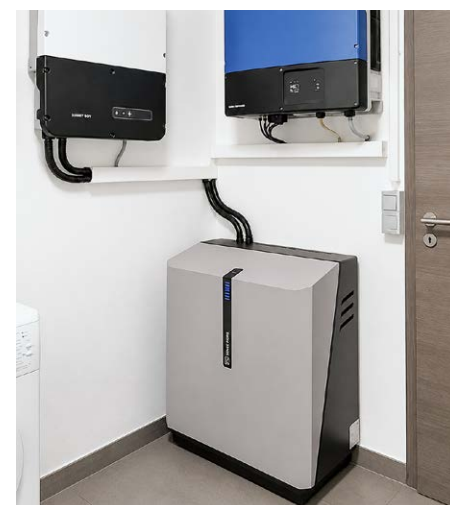
Mehr Eigenverbrauch dank Stromspeicher.
